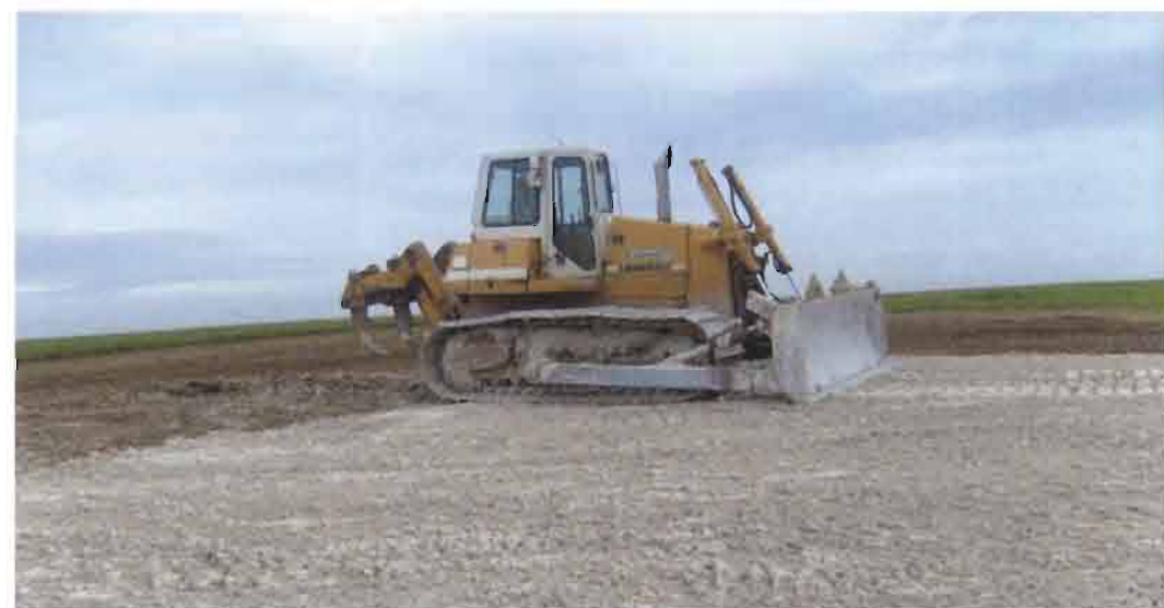
Aire stabilisée d'Hermaville en cours d'aménagement pour le traitement des déchets verts.
