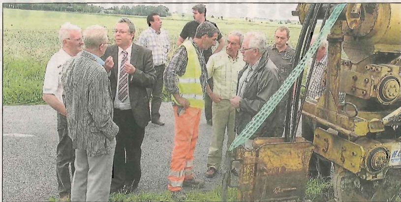
Les élus en discussion sur le passage de l'engin creusant les tranchées, entre Izel et Avesnes.
